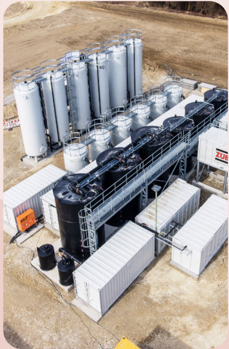
Bild 11: Kontaminiertes Grundwasser wird über eine Grundwasseraufbereitungsanlage mit mehreren Verfahrensschritten saniert.
